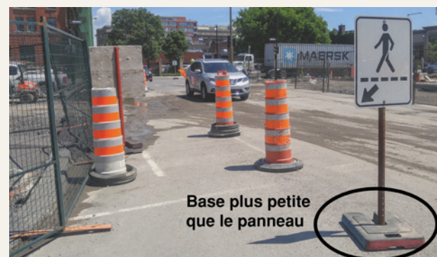
MAUVAIS EXEMPLE DE BASE DE PANNEAU
