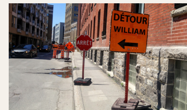
MAUVAISE GESTION DE PASSAGE DE CHANTIER
