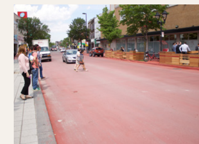
POUR ASSURER UNE MEILLEURE POSE DE LA PEINTURE DANS LA RUE ONTARIO, L'ARRONDISSEMENT MERCIER-HOCHÉLAGA-MAISONNEUVE A PROCÉDÉ AU RESURFACÉGE DE LA CHAUSSÉE. CÉPENDANT, L'ADHÉSION DU PRODUIT DE MARQUAGE N'A PU ÊTRE OPTIMALE EN RAISON DE CHALEUR EXTRÊME AU MOMENT DE LA POSE DU PRODUIT, ENTRAÎNANT UN PHÉNOMÈNE DE RESSUAGE 44 .
